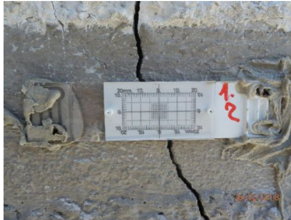
Figura 32 – Foto della “lesione 1.2” in data 26 febbraio 2018 (data di messa in posto del fessurimetro). La misura dell’apertura è di 2.1 mm.
