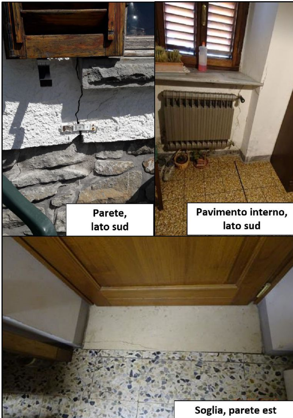
Figura 16 - Lesioni riscontrate dall'edificio 3 durante i sopralluoghi effettuati.
