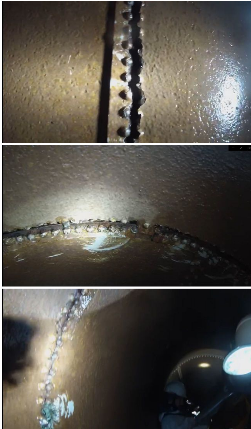
Figura 61: screenshots dal video ispezione eseguito all'interno della condotta forzata a valle della vasca di carico ENEL: tale video mostra all'interno della condotta forzata un'evidente rottura (Allegato 6).
